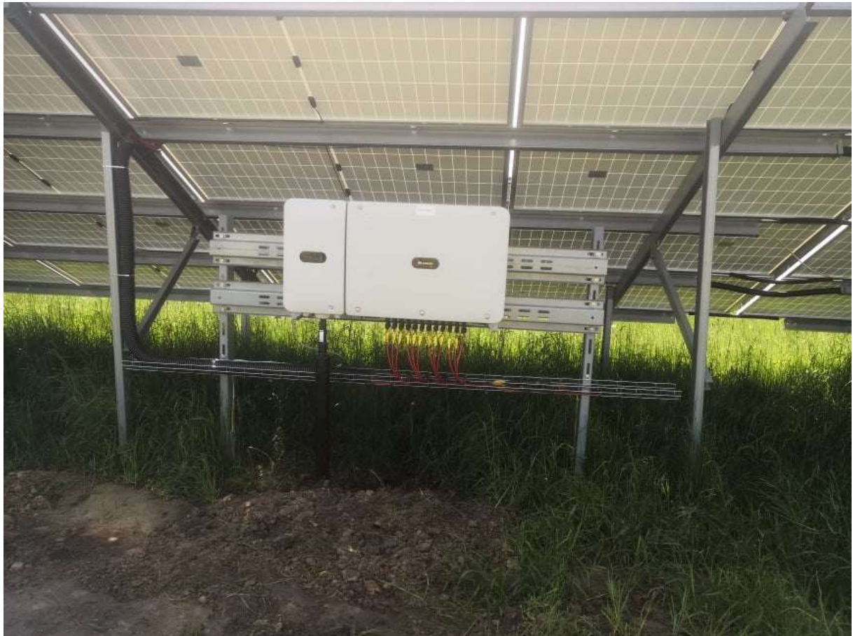
Ryc. 8 Falowniki (inwertery) zainstalowane na konstrukcji wsporczej.
