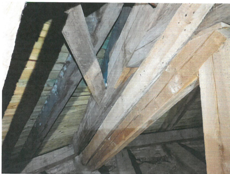
Fot. 11 Nad prezbiterium wykonano miejscowe wzmocnienia, natomiast nie są one stabilne, gdyż drewno nie zostało spasowane i szczeliny uzupełnione są klinami.
