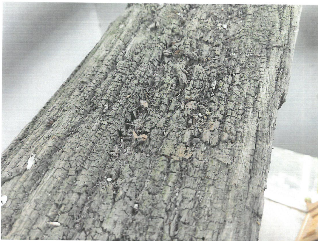
Fot. 33 Struktura drewna pozbawiona parametrów technicznych
