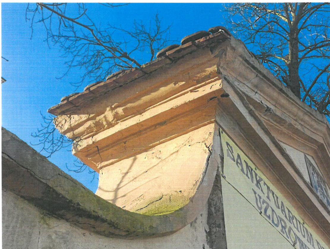
Fot. 39 Wykwity na tynku, odspojony tynk, łuszcząca się farba, utracony rysunek detalu gzymsu, ubytki w dachówce ceramicznej.
