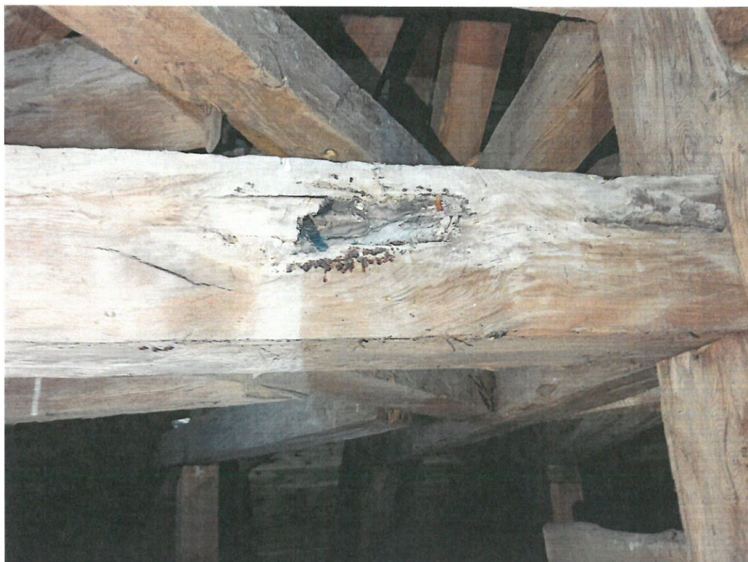
Fot. 19 Ubytki w budulcu nad prezbiterium.
