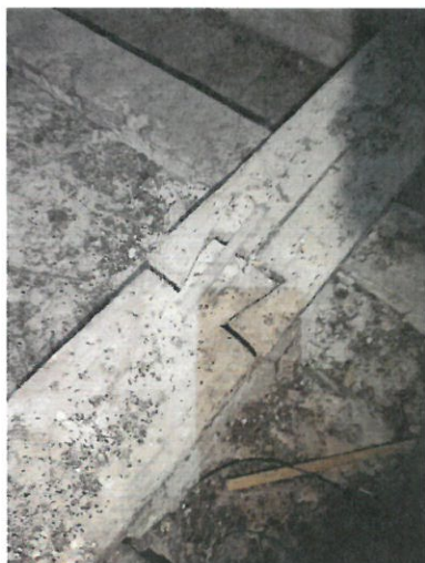
Fot. 8 Belka podwalinowa łączona na pióro i wpust. Łączenie wzmocnione metalową klamrą.
