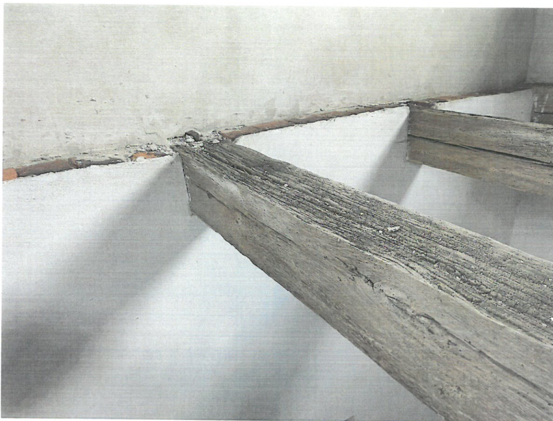
Fot. 31 Belki rozporowe straciły parametry techniczne, drewno przewietrzone, puste w środku.
