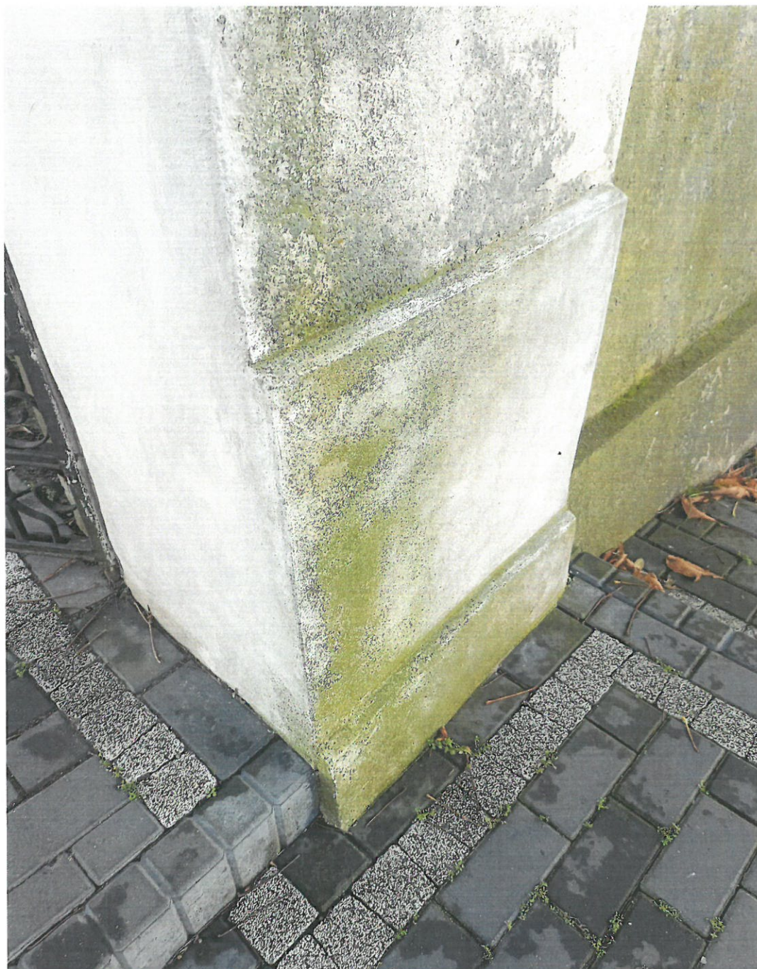
Fot. 43 Wykwity na tynku i farbie, miejscami głuchy tynk.
