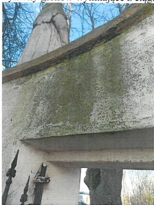
Fot. 38 Wykwity na tynku, odspojony tynk, łuszcząca się farba.
