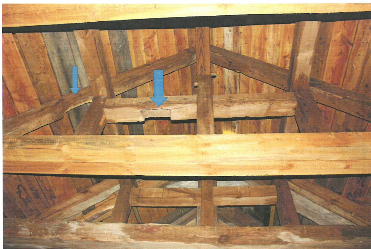
Fot. 25 Więżba dachowa nad sklepieniem ceglany. Bardzo duże spustoszenie budulca poprzez ingerencję owadów. W wielu miejscach już na nowym deskowaniu pod pokryciem dachowym widoczny jest atak insektów.
