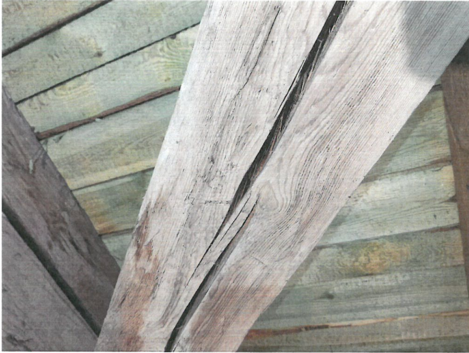
Fot. 14 Widoczne głębokie pęknięcia budulca.
