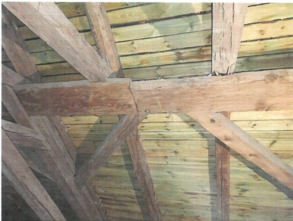
Fot. 18 Przemieszczenie i odkształcenie ramy stolcowej leżącej na połaci. Na całej długości i szerokości połaci dachowej widoczne wymienione deskowanie.
