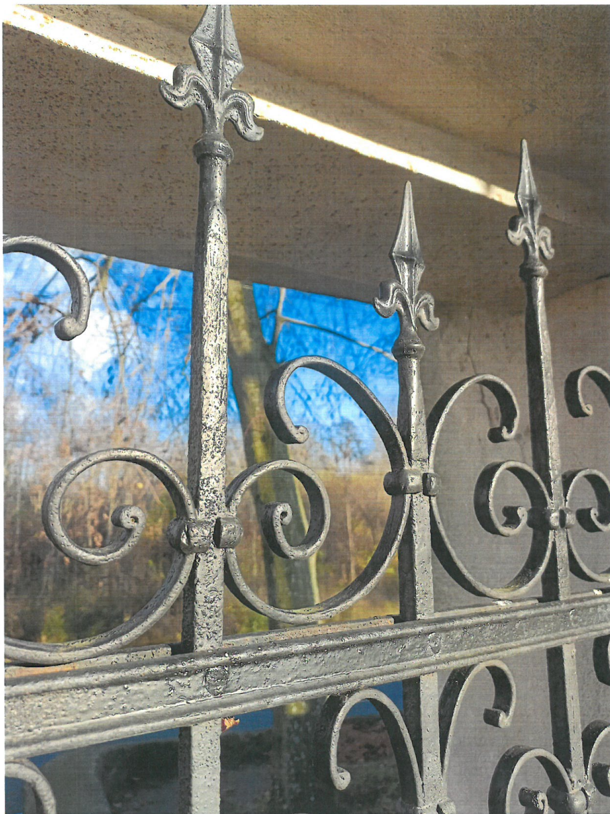
Fot. 45 Postępująca korozja pod farbą.
