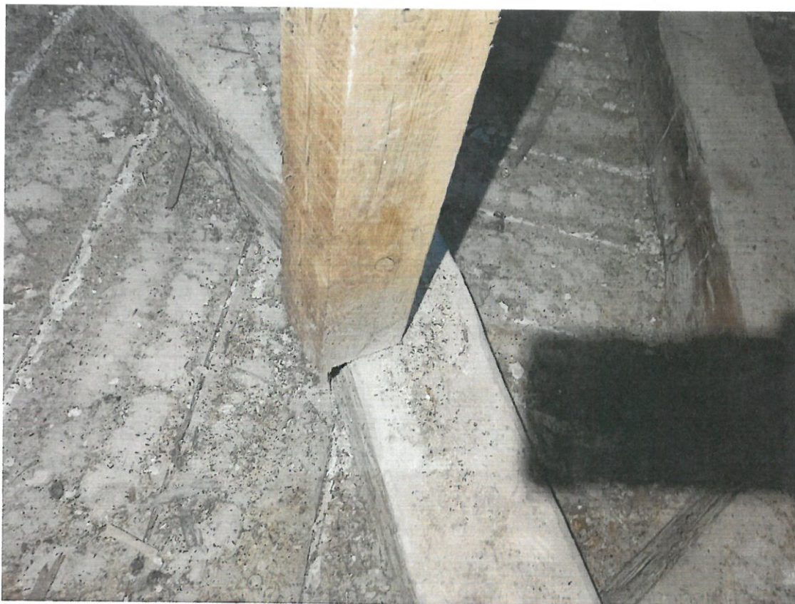
Fot. 20 Luźny słup nowej konstrukcji wzmacniającej, wiszący na płatwi połączeniowej, należy pilnie go osadzić bądź zdemontować.
