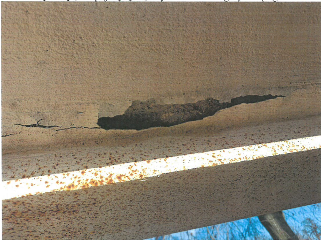
Fot. 42 Skorodowana belka nadproża nad furtką, odspojona farba.
