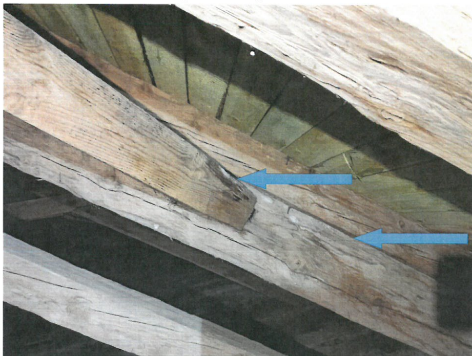
Fot. 17 Liczne ubytki w przekroju oraz sinizna drewna
