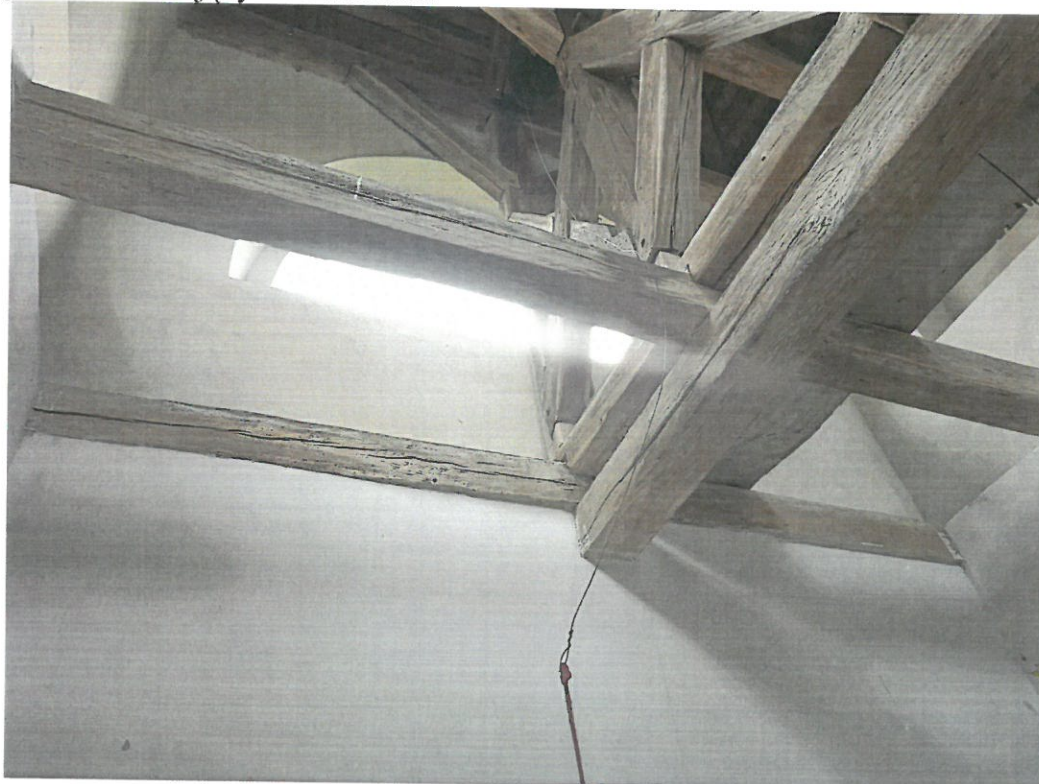
Fot.30 Znaczące pęknięcia powstałe w wyniku przesuszenia i przepalenia budulca.
