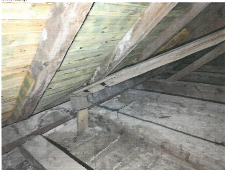
Fot. 9 Elementy drewniane porażone przez grzyby domowe Serpula Lacrymans . Widoczny biały nalot na deskach jak również i elementach konstrukcyjnych wywołany jest przez grzyby. Wymienione, nowe deskowanie.
