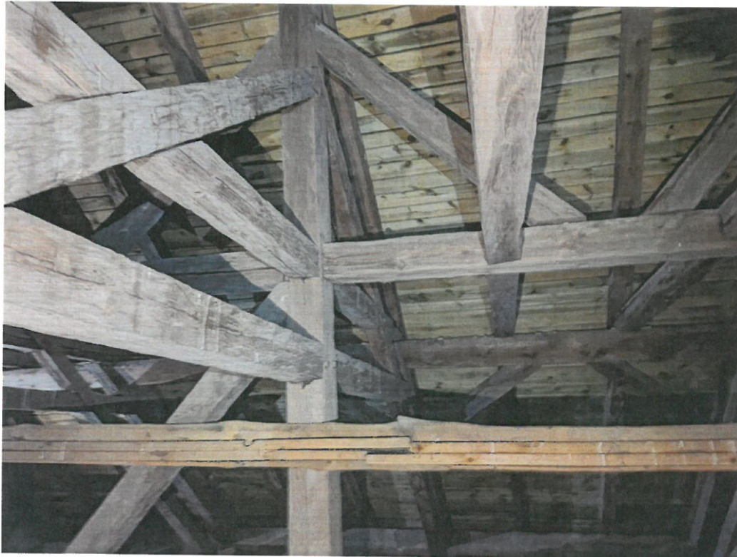
Fot. 13 Wprowadzono w deskach poziomych instalację elektryczną, co stanowi zagrożenie pożarowe.
