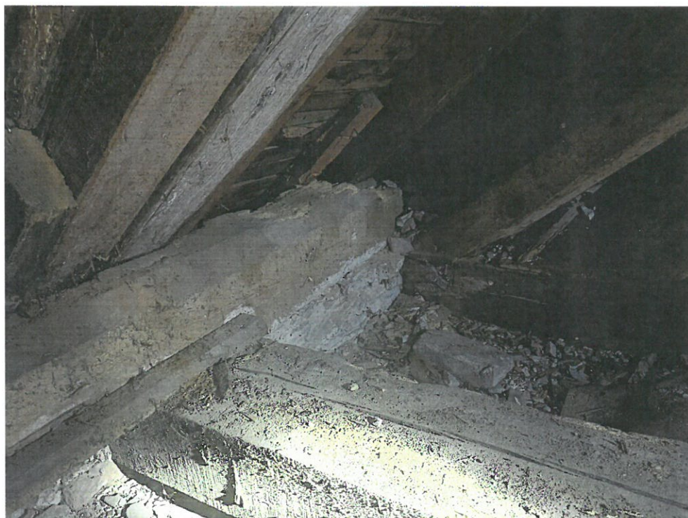
Fot. 2 Belka stropowa połączenie przy gnieździe. Widoczne zniszczenia wywołane ingerencją owadów (spuszczel pospolity i kołatek domowy)
