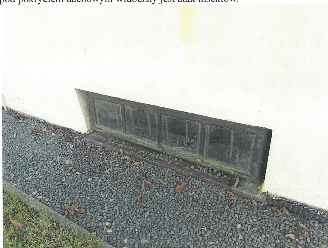
Fot. 26 Okna w krypcie-ramy nieszczelne, drewno odkształcone, pęknięte szklenie
