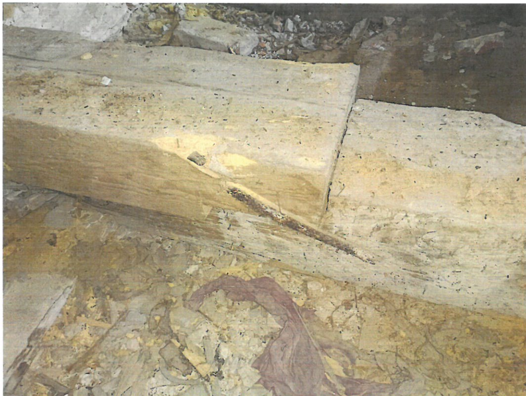
Fot. 1 Belka stropowa. Widoczne zniszczenia wywołane ingerencją owadów (spuszczel pospolity i kołatek domowy)
