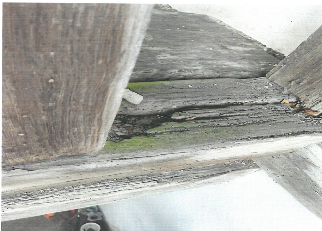
Fot. 36 Uszkodzone elementy ramy stolcowej w osi.
