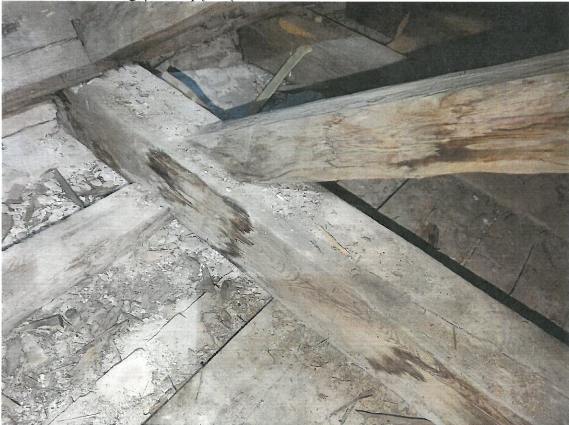
Fot. 15 Widoczne zagrzybienie wszystkich elementów konstrukcyjnych powstałe w wyniku wcześniejszych nieszczelności.
